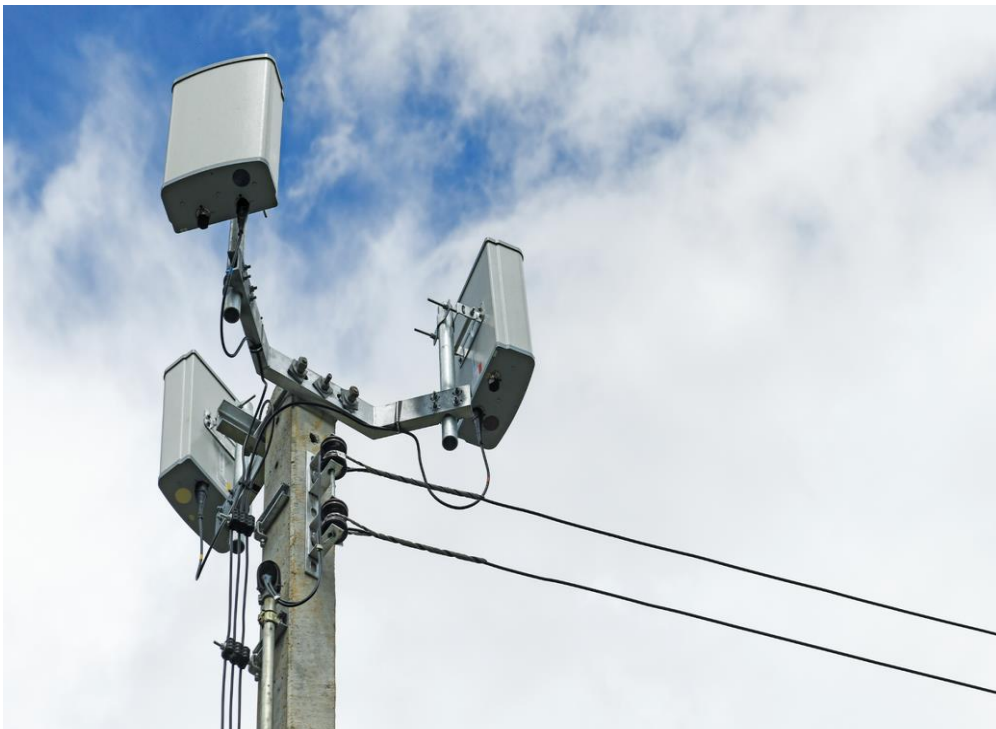
Εικόνα 6. Small Cell εγκατεστημένο σε στύλο. [19]
