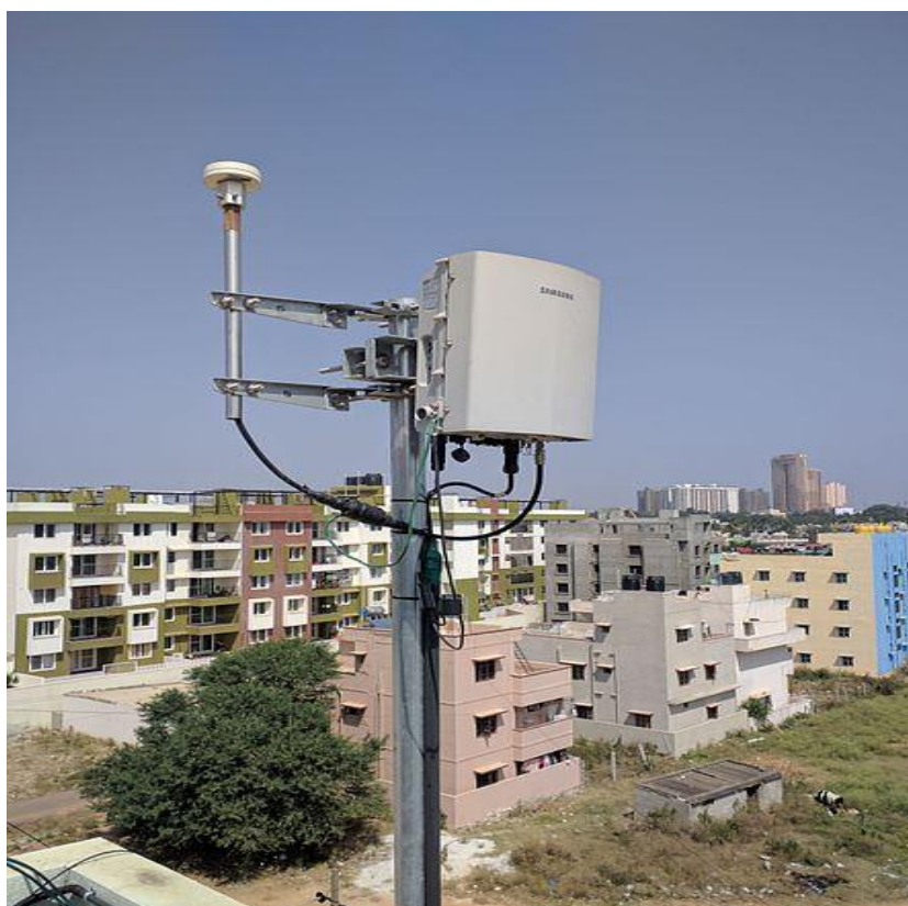
Εικόνα 8. Ένα small cell εγκατεστημένο στη τάρτασα εντός κτηρίου [15]
